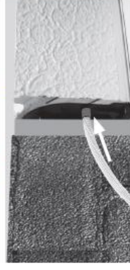
Casser l'opercule de la joue, passer la gaine et le câble d'alimentation, puis réaliser l'étanchéité à l'air de l'intérieur à l'aide de mastic.
